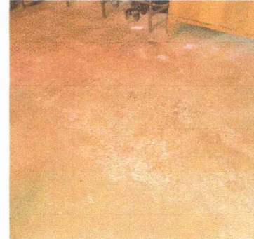
Foto 4: Se observa el mal estado del piso.
