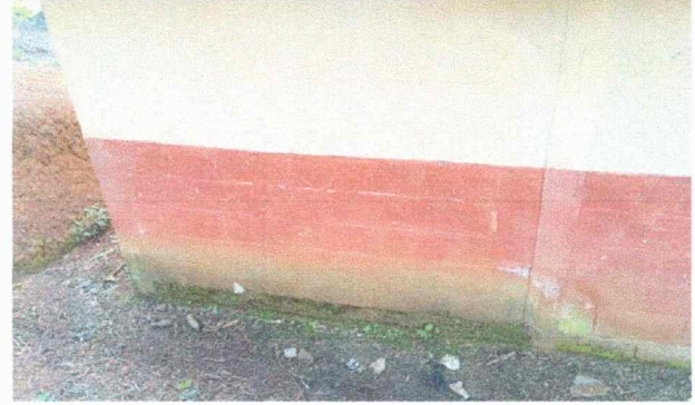
Foto 2: Se observa presencia de humedad en pared.
