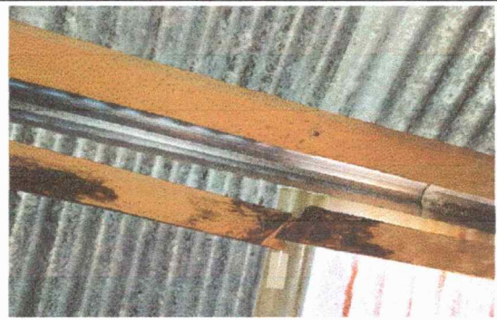
Foto 6: Se observan reglas quebradas parte del techo.
