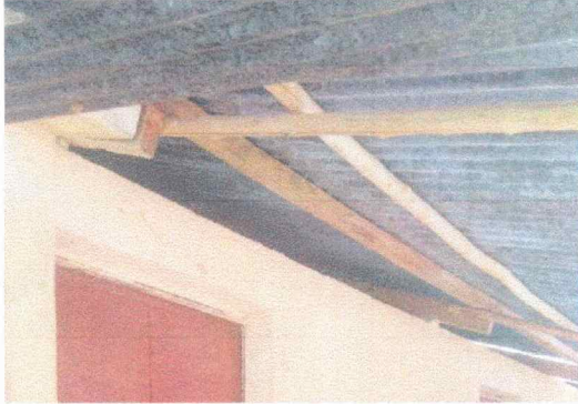
Foto 1: Se observa que las Vigas y Reglas están deterioradas.
